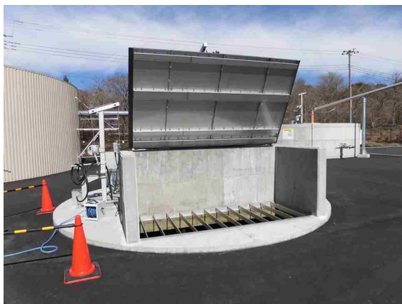
運転開始前（原料槽）
