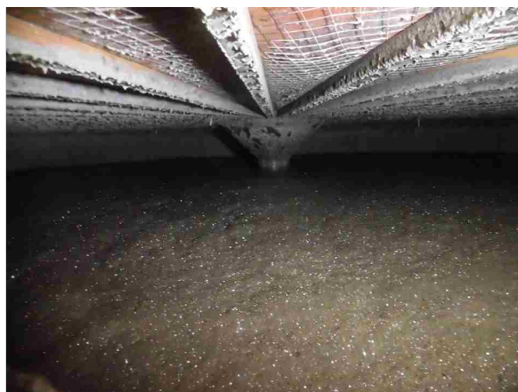
発酵槽点検窓 (18. 5. 9)
