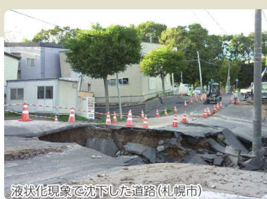
液状化現象で沈下した道路（札幌市）
