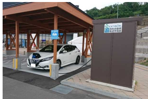
【設置例】石狩「あいろーど厚田」
