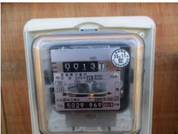
* 仮設電源引込作業 困いわな壁部に設置した 100V 用 メーター
