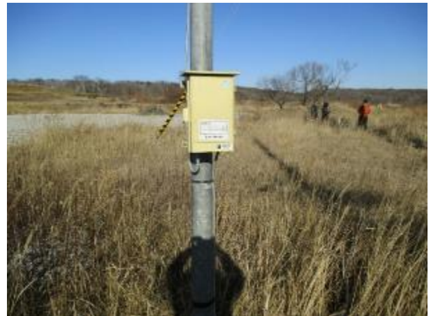
* 仮設電源引込作業 電源コード等に支障が出た場合のためブレーカー設置対応 * 仮設電源は 2月25日に撤去済
