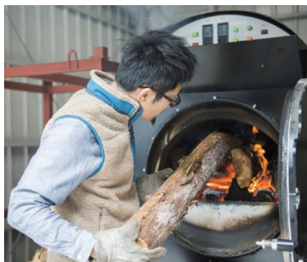
温泉施設の薪ボイラー
