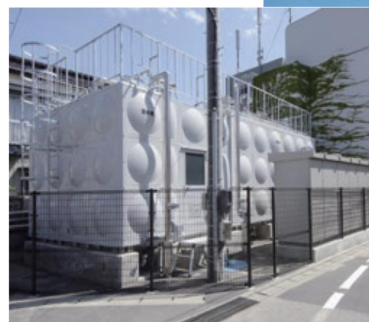
集中給湯設備
