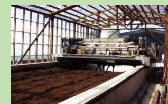
良質な堆肥を供給する 堆肥化処理施設
