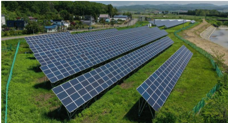
栗山太陽光発電所（499kW）
