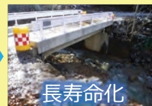
橋梁の老朽化
