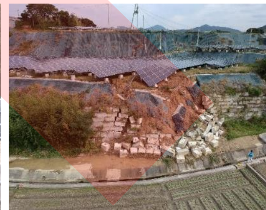
法面保護工が崩れて流出した事例
