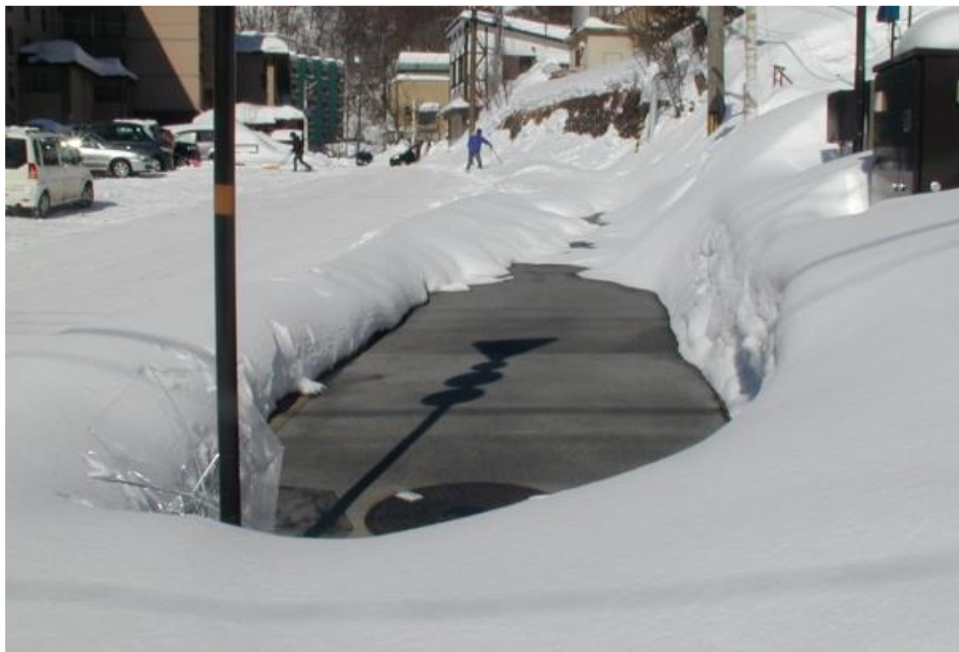
温泉熱を活用した融雪設備
