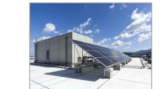
再生可能エネルギー施設 (太陽光発電施設 等)
