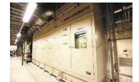
コージェネレーションシステム (CGS)
