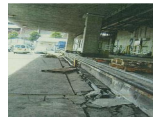
地震による施設被害
