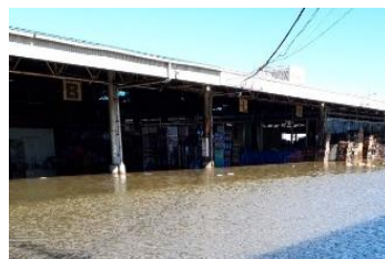
大雨による浸水被害（荷捌場）
