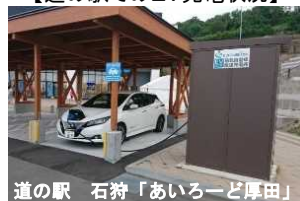
【道の駅でのEV充電状況】
