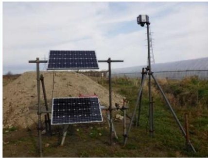
[ソーラーパネル設置状況]
