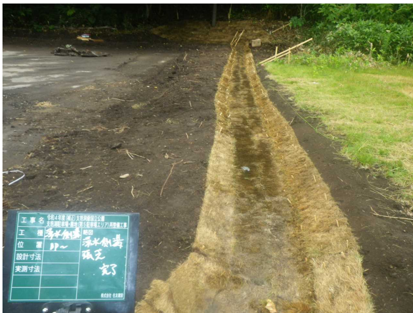
排水設備 芝側溝
