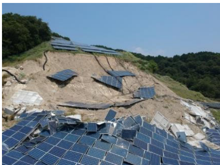
土砂崩れで生じた崩落
