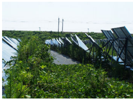
不十分な管理で放置されたパネル
