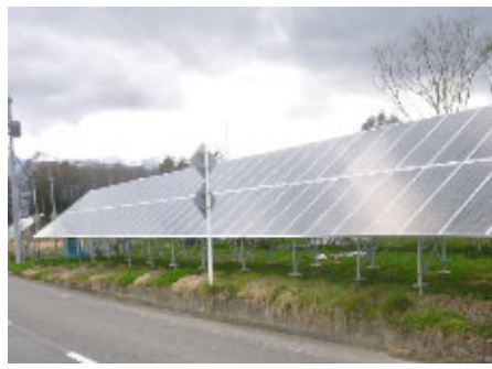
柵塀の設置されない設備
