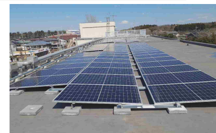
公共施設屋上に設置の太陽光
