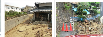
被災状況写真 ③
