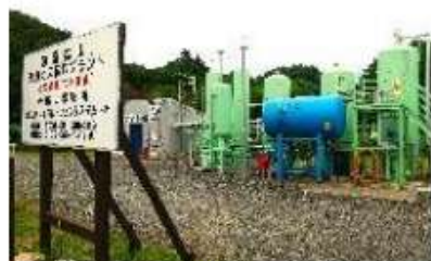
天然ガス採取プラント
