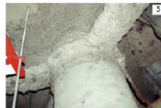
吹付け石綿（鉄骨耐火、被覆材）：レベル1
