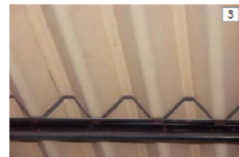
屋根用折板石綿断熱材：レベル2
