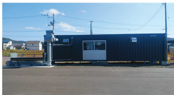
木質バイオマスバイラー（コンテナ型）外観
