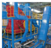
金属破砕・選別設備
