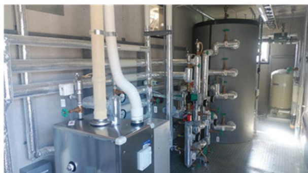
木質バイオマスバイラー（コンテナ型）内部
