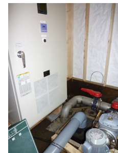
幌尻山荘の給電施設
