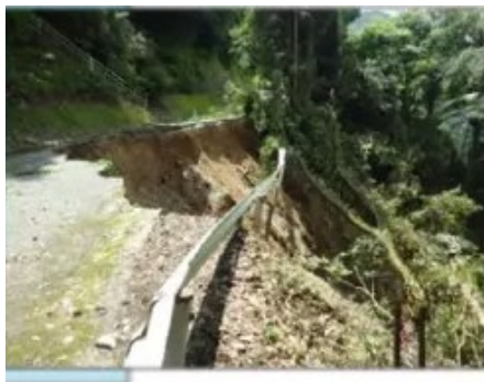
道路崩壊（甲佐町）
