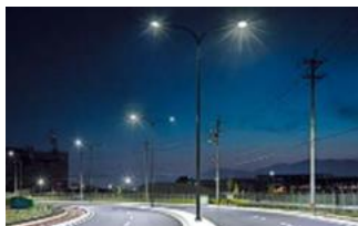
【道路照明のLED化】
