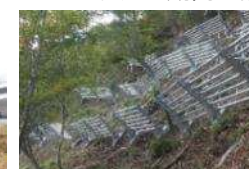
なだれ防止施設
