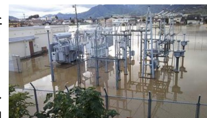
台風により水没した変電所
