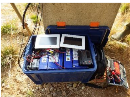
赤岩展望台下に設置したバッテリー等機材
