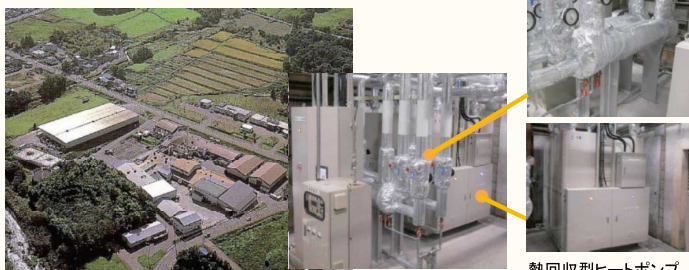
熱回収型ヒートポンプ
