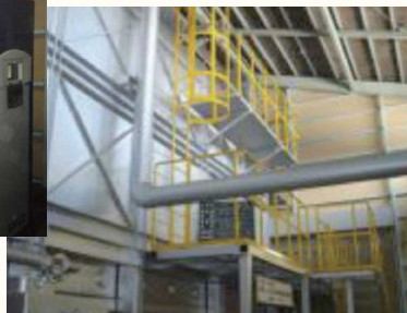
バイオマスボイラー
