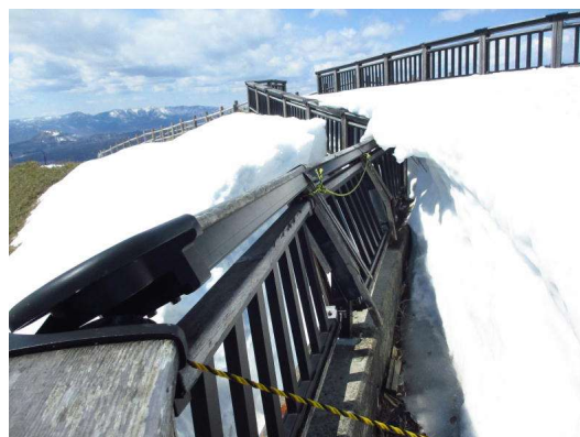
雪圧による木柵（鋼材併用）被害状況
