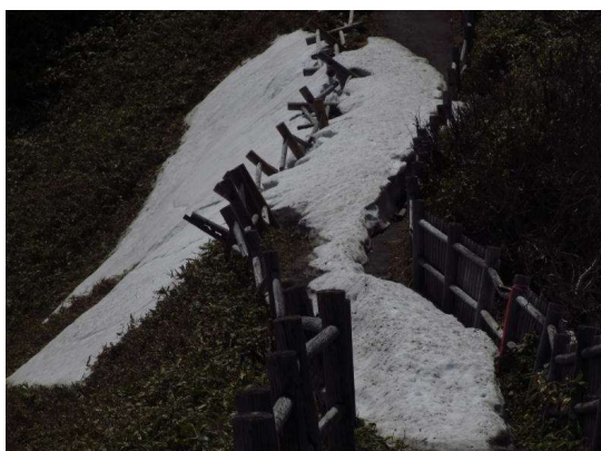
雪圧による木柵被害状況
