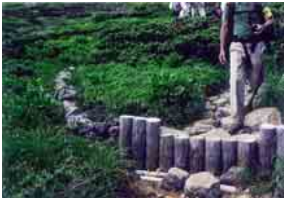
写真 8 水通しの土留め処理と石を用いて水を誘導することを試みている。丸太が飛び出たり根際の浸食が見られる。
