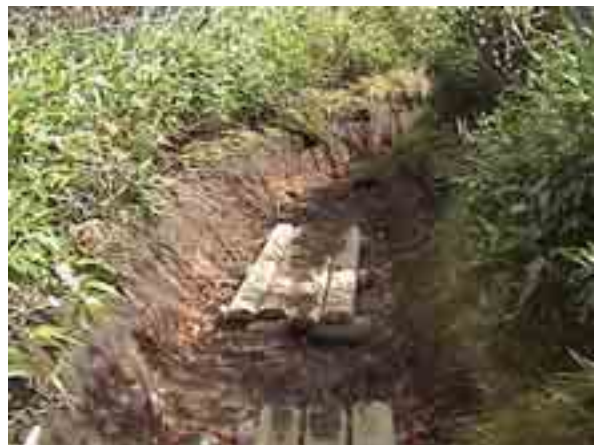
写真 48 トラバース箇所での水路化（裾合平）
